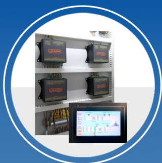
دستگاه کنترلر هواساز
